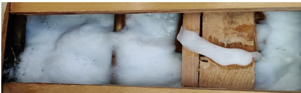
Biozider Schaum aus SFS und Sanosil S015 in einem Unterlagsboden / Estrichdämmung nach Wasserschaden mit Schimmelpilzbefall.
